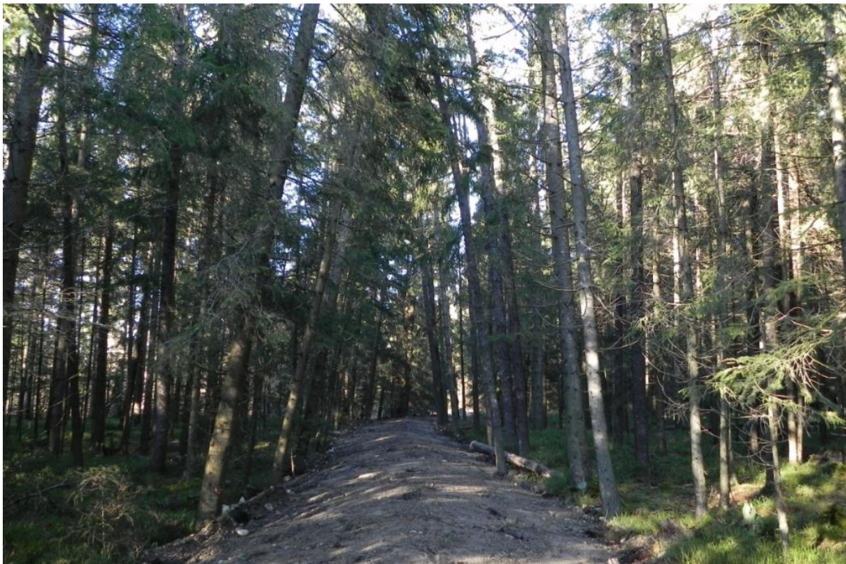
Abbildung 1: Das hohe Gewicht des Kiesweges drückt die Wurzeln der Fichten in dem weichen Torfboden nach unten; Dadurch neigen sich ganze Stämme zur Wegemitte und stellen eine Verkehrsgefahr dar.
